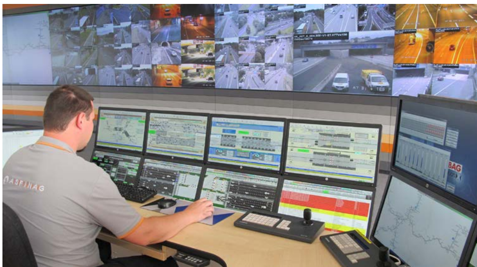
Abbildung 2: Verkehrsmanagementzentrale (VMZ) in Wels © ASFINAG
